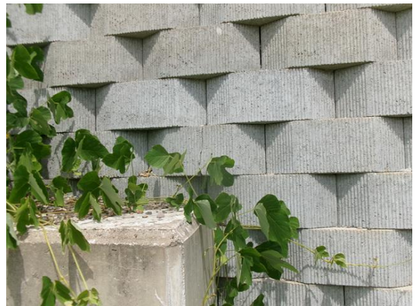
S3 블록 균열(1EA)
